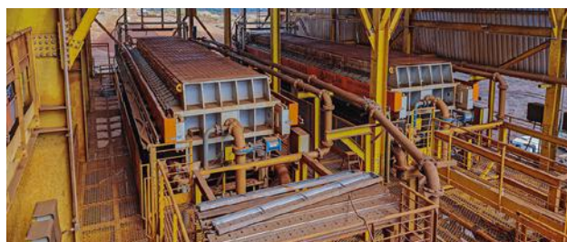
Detalhe do Filtro-prensa da Herculano
