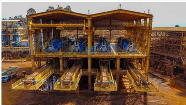
Planta de filtragem da Itaminas
